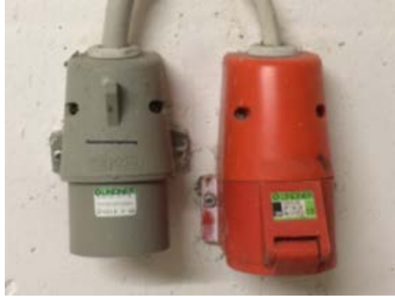
Abb. 6: Sichere Notstromspeisung in das Stromnetz eines Gebäudes. Foto: I. Brandmüller, LRA Altötting
