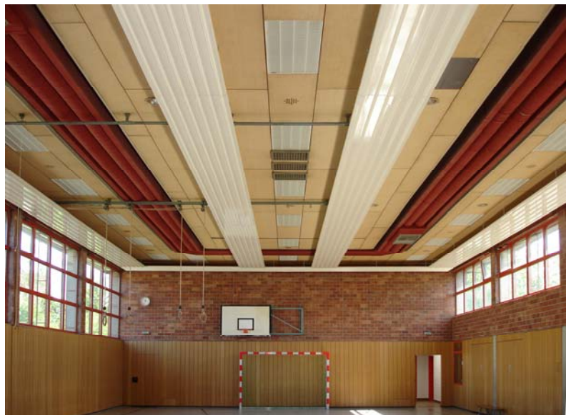
Deckenheizung in fertigem Zustand
