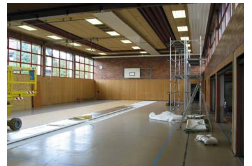
Mehrzweckhalle Issigau, Heizung
